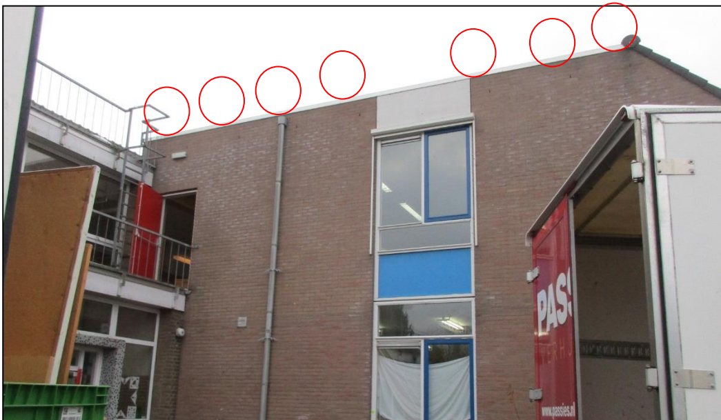
Foto 5: Open stootvoegen (rood omcirkeld) in het schoolgebouw
