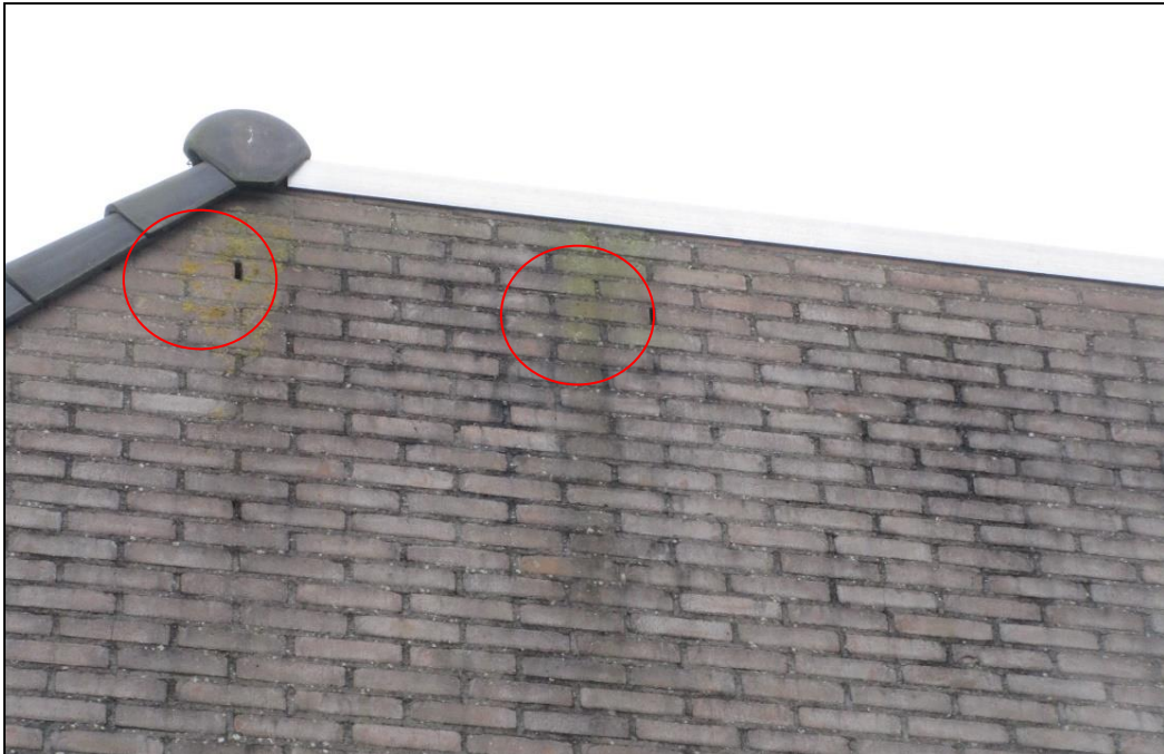
Foto 4: Open stootvoegen (rood omcirkeld) in pand van het schoolgebouw
