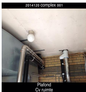
Foto 3: Asbesthoudend plafond, moeilijk te saneren.
